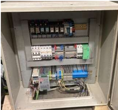
Figuur 4: Elektrische bedieningskast
